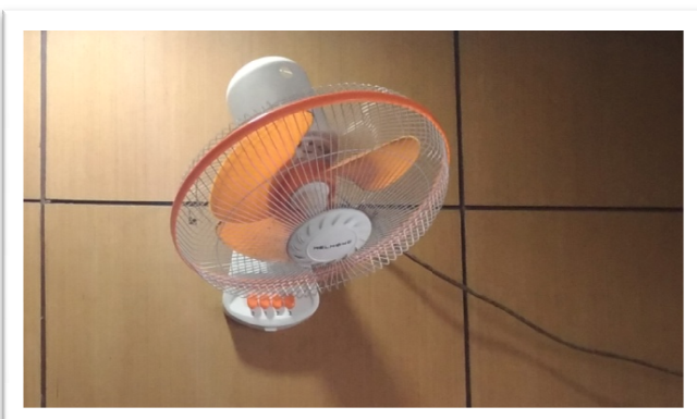
Kipas Angin di Ruang Pelayanan
